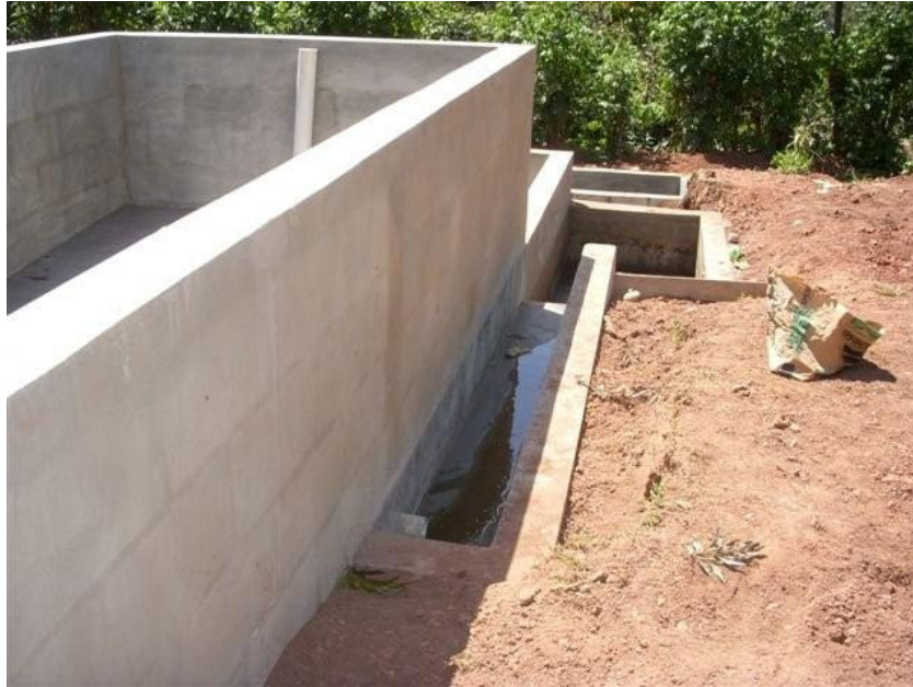
Foto 7. Planta de tratamiento de aguas residuales
